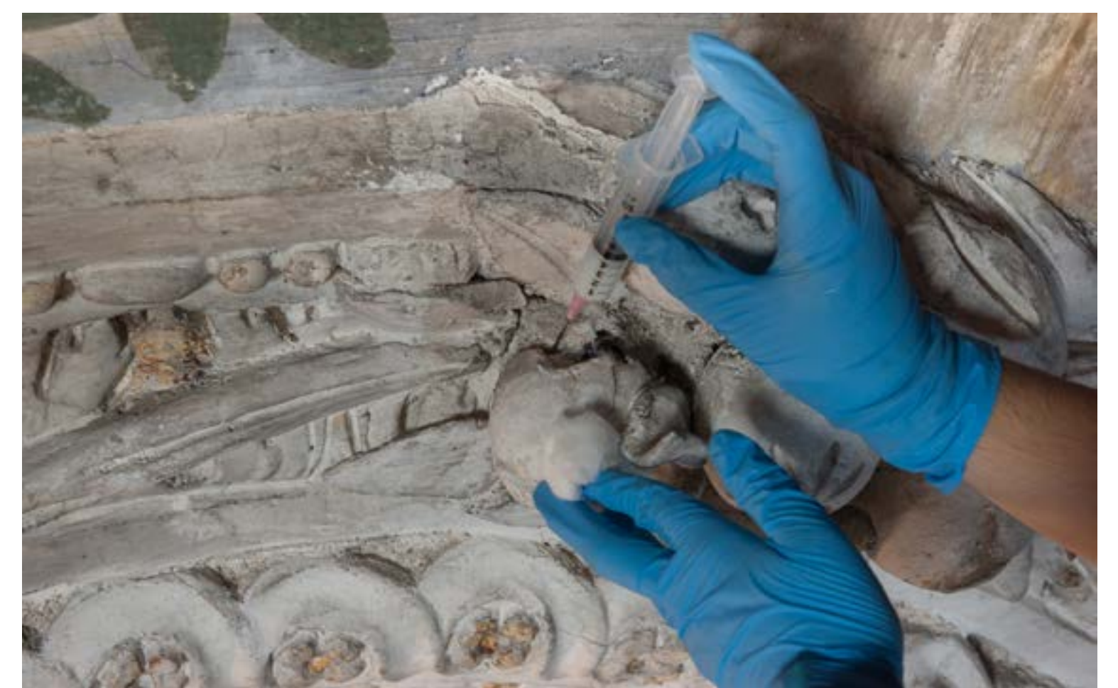
Fig.4 : Adesione di elementi in stucco in pericolo di distacco, 2018.
